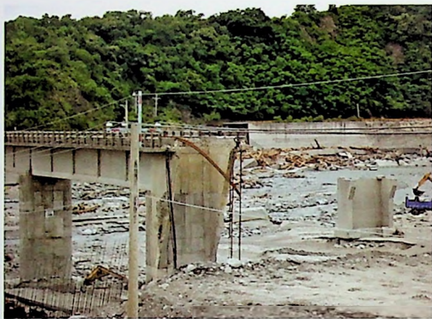
八八水災沖毀的台鐵南迴線太麻里溪橋
